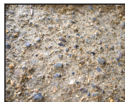
Bakterierisk på betong
